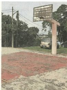
▲万挠篮球场建于1995年，已经多处损坏。
