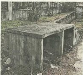
▲篮球场看台底部已崩裂，需要重修。
