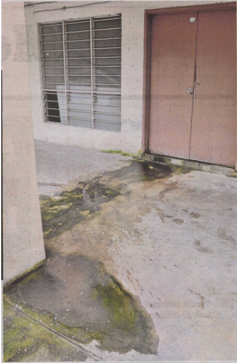
KEADAAN air yang bocor menyebabkan permukaan lalu kotor.
